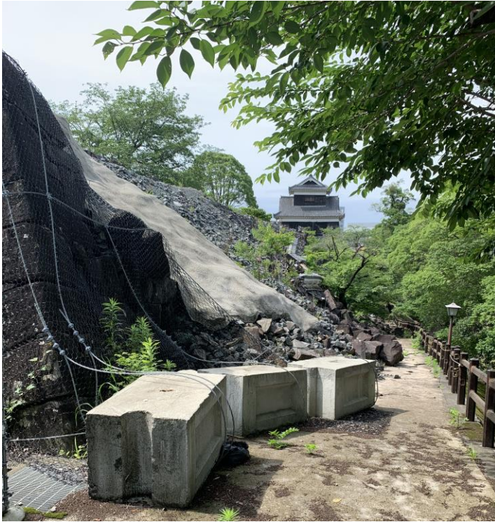
Fig.2 崩れて修復を待つ石垣
